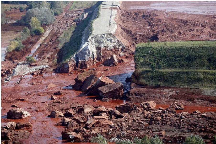
Vista del muro y del lodo rojo después de la rotura [fotografía: Kormányzati Kommunikációért Felelős Államtitkárság]
